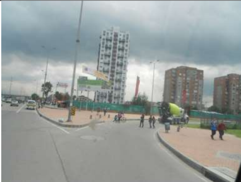
FOTO 3. ELEMENTOS INSTALADOS EN LA AVENIDA CARRERA 45 CALLE 183 del 22-02-2014
